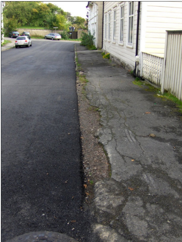
Manglende prioritering av gående ved dekkelegging.
