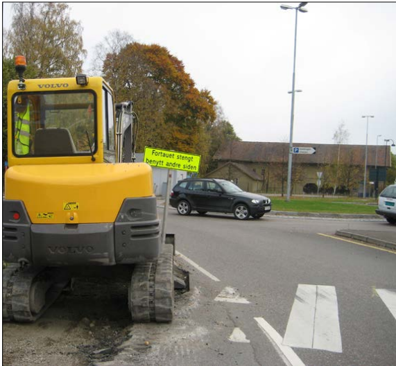
Manglende hensyn til de myke trafikanter.
