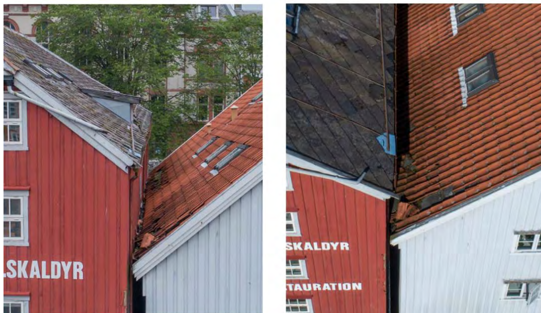
Figur 15: Skader på taket til Kjøpmannsgata 9 (til høyre). Foto: Gravur Studios, Rambøll Norge [2].
