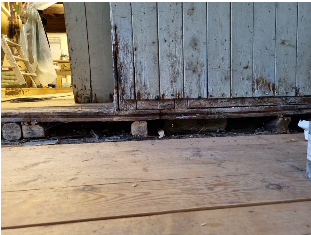
Figur 18: Eksempel hulrom under oppforet gulv.
