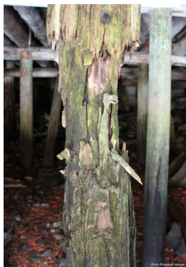
Figur 7: skadet perling/ fundament. foto: Rambøll.
