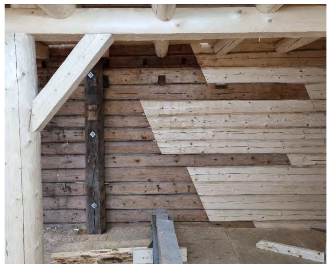
Figur 8: eksempel fra brygge hvor mye av tømmeret i bærende konstruksjoner er byttet ut med nytt tømmer, på grunn av skader.
