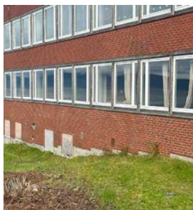
eksponert ringmur av betong i flukt med tegl som avtrappes med terreng på vestsiden av bygg C
