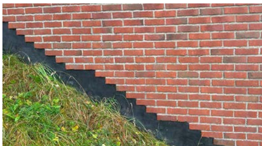
ringmur av betong i flukt med tegl og påført en sort membran (nordsiden av bygg C)
