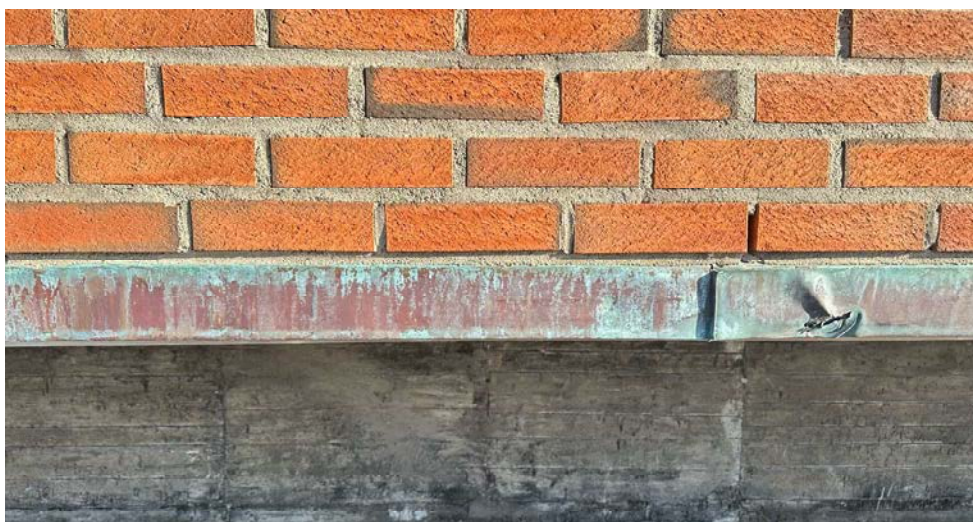
Kopperbeslag med stående fals i underkant av teglforblendingen med samme høyde som tegl med mørtel (bygg E)
