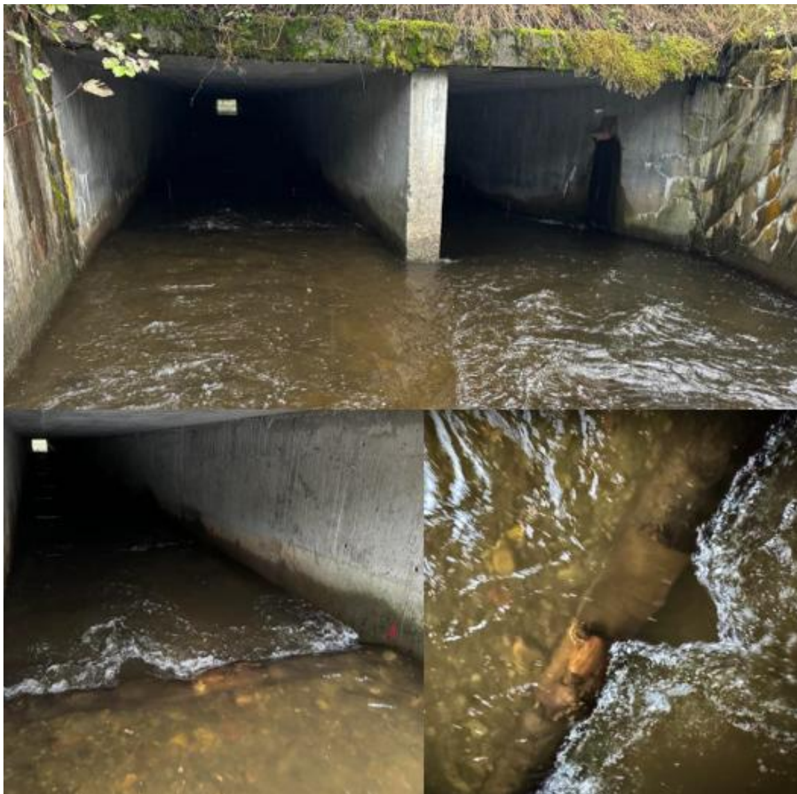
Figur 30. Status på terskler i dobbelkølvert under avkjøring til Romolslia høsten 2024 i gytetiden for sjørret (oktober 2024). Installasjonene fungerer perfekt, med god vanngjennomstrømming gjennom venstre kulvertløp med fastmonterte buner. Foto på middels til høy vannføring i Leirelva oktober 2024, da mesteparten av gytefiskvandring foregår i elva.
