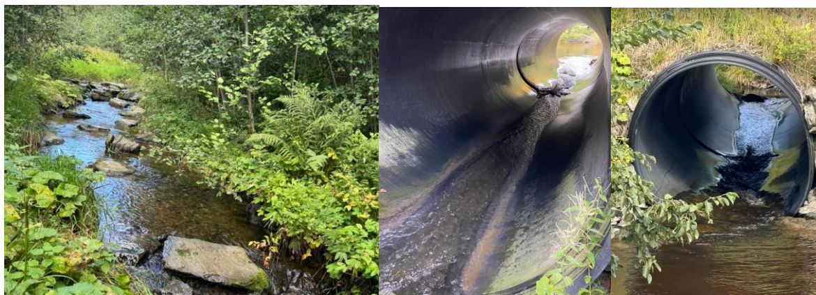
Figur 105. Del av st. 17-3 (t.v.) på strekninger oppstrøms en vandringshindrende veikulvert under Mebygdveien.
