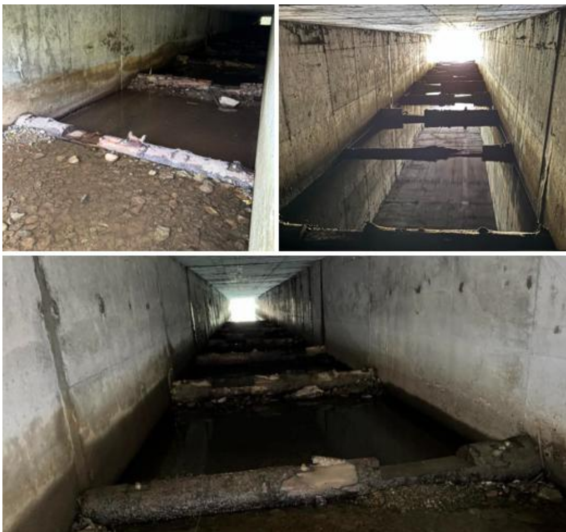
Figur 29. Status på terskler i dobbelkulvert under avkjøring til Romolslia høsten 2024. Installasjonene har erfart flere store flommer og isganger. Foto på svært lav vannføring i Leirelva i august 2024, da mesteparten av vannføringen går i motsatt kulvertløp.
