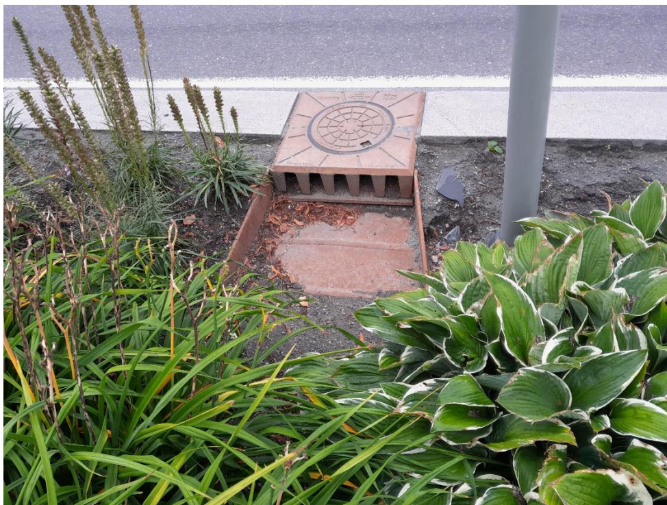
Figur 11 Bruk av kjeftesluk for å sende regnvann gjennom kantstein fra veg til regnbed. Foto: FREK/Rambøll, aug-23
