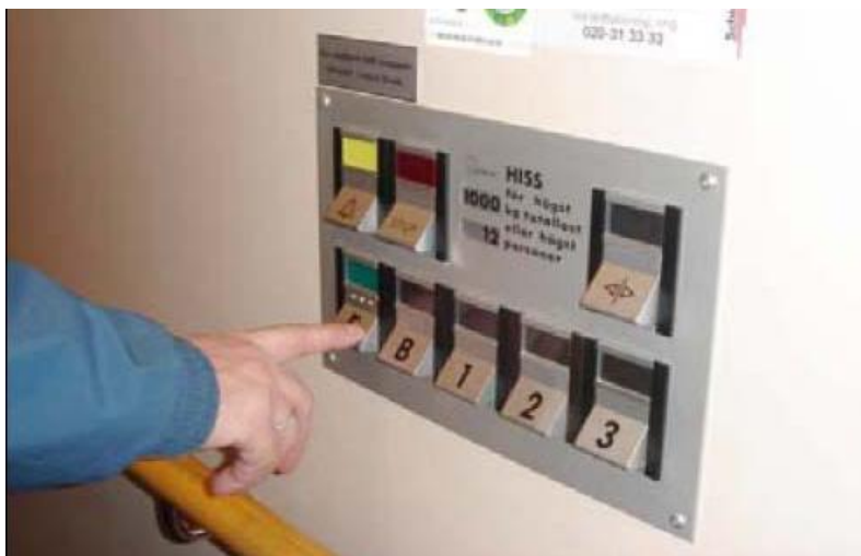
Eksempel på taktil merking av kontrollpanel i heis
