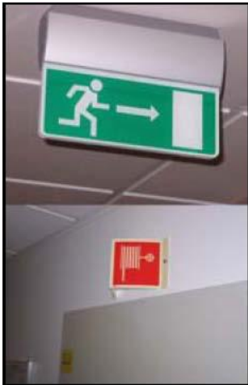
Eksempel på skilt som markerer rømningsvei
