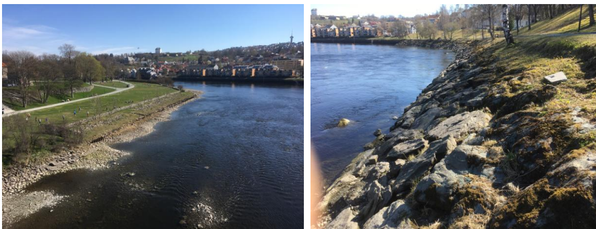
Langs Marinen er elvebredden naturlig (t.v.), mens i planområdet er det en plastret fylling fra 60-tallet (t.h)
