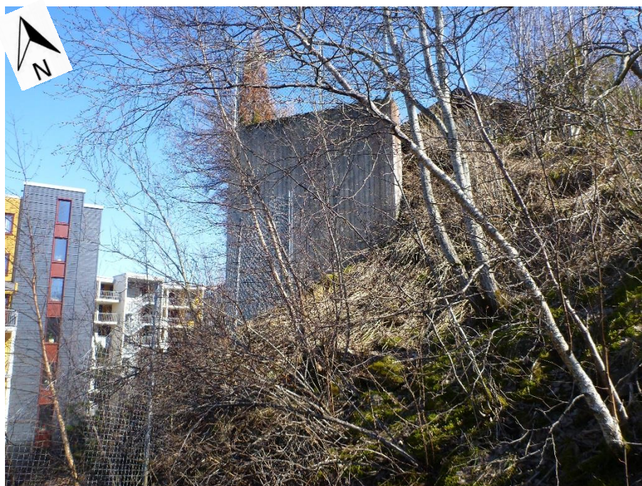
Foto 4: Mur nedenfor (vest for) Brit Grytbaks veg 18.
