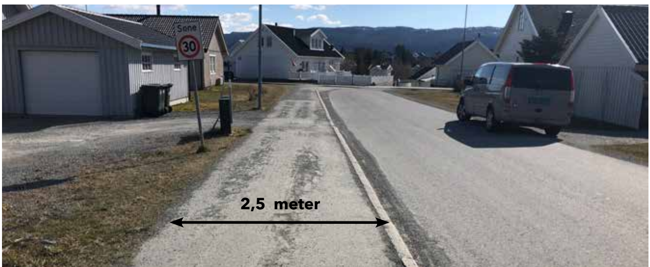
Flatheimvegen sett fra fv 704: Fortauet har en jevn overflate og er normalt slitt uten vesentlige skader.
