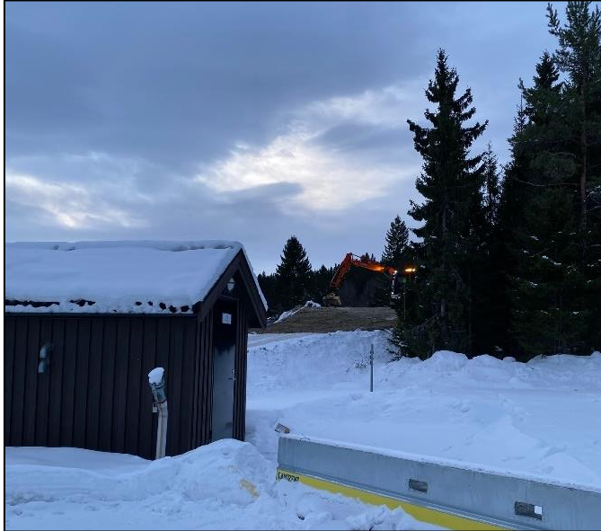
Figur 5: Pumpestasjon avløp Granåsen (PA48)
