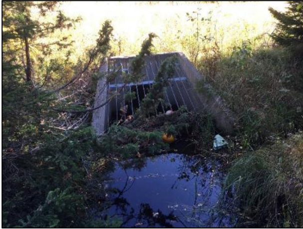
Figur 7: Inntak av vann fra myr ved rekrutthoppbanlegget
