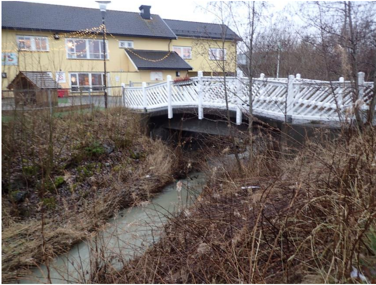
Figur 12 På strekningen ligger en bru som går over til Sjøskogbekken barnehage.
