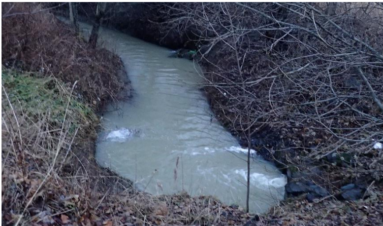
Figur 5 På bildet ser man Sjøskogbekken rett oppstrøms inntaket til kulverten som går gjennom E6. Det er høy vannstand oppstrøms innløpet av kulverten på grunn av at risten, som dekker litt over halve tverrsnittet, inn til kulverten er tett. Dette reduserer kulverten sin kapasitet betraktelig.
