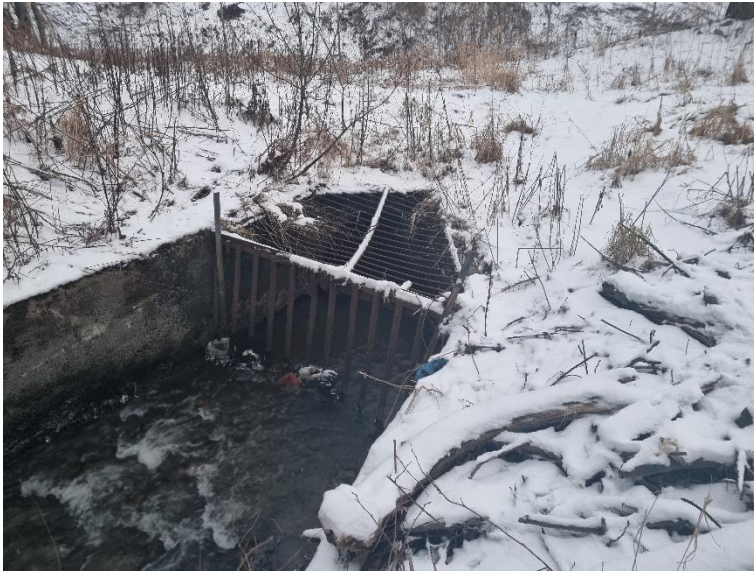
Figur 10 Innløpet til kulvert 3 under jernbanen. Bak risten kan man se at bekken har gravd inn under muren på høyre side. Det er planlagt å erstatte denne kulverten med to kulverter med dimensjon \varnothing 1800 mm (Rambøll Norge AS, 2018). I undersøkelser av avbøtende tiltak ønsker Trondheim kommune at de nye kulvertene skal legges til grunn i beregningene.
