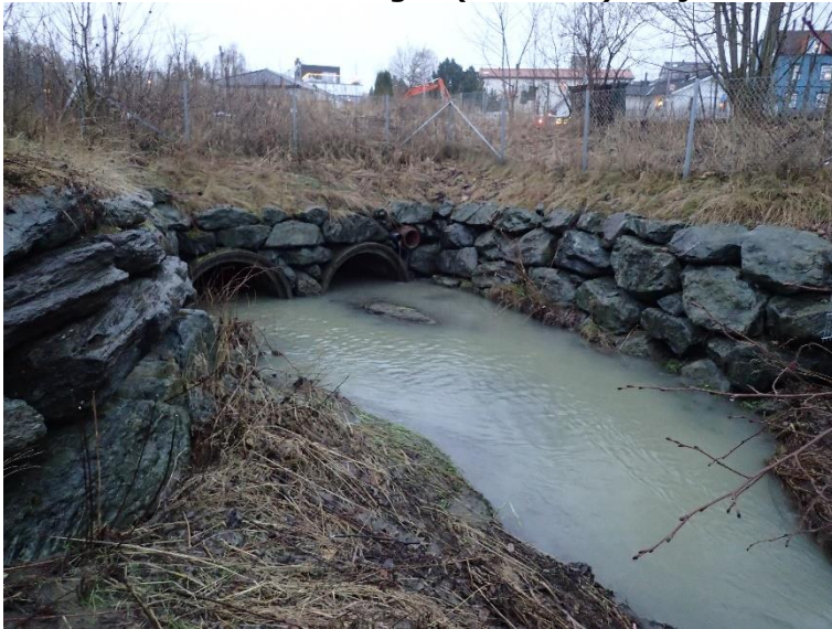
Figur 16 Kulvert nummer 4 sett nedstrøms. Kulverten mot vest har mindre vannføring. Nedstrøms kulvertene ser man at det er mye sediment som er bygd opp. I beregninger for avbøtende tiltak ønsker Trondheim kommune at det skal legges til grunn at disse er nesten frie for sedimenter.
