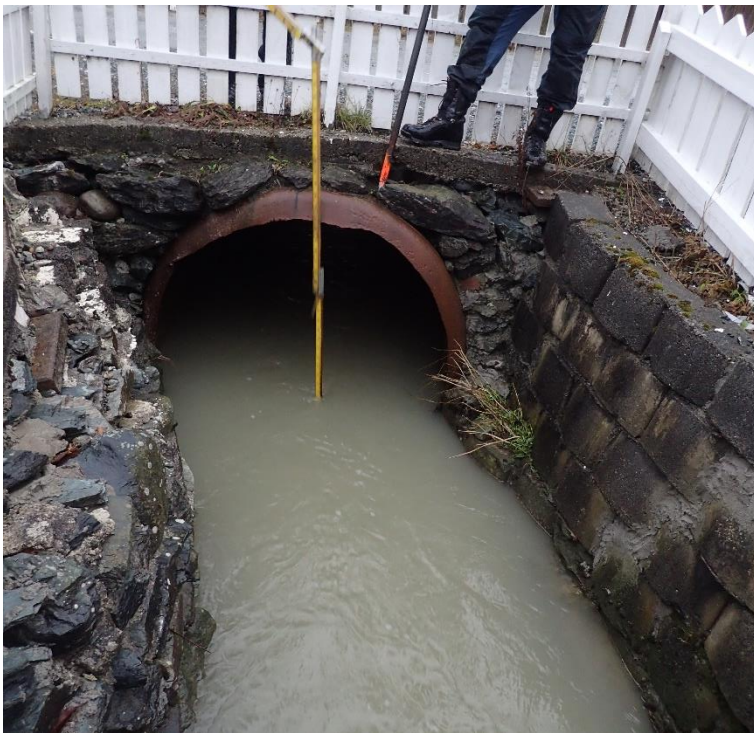
Figur 9 Kulvert 2 sett fra oppstrøms. Denne kulverten er privat. Huseier informerte om at kulverten er en tank med fjernet topp og bunn fra Franzefoss. Tanken har seget sammen, og er nå videre i bredden enn i høyden. Høyden er cirka 1,2 m.
