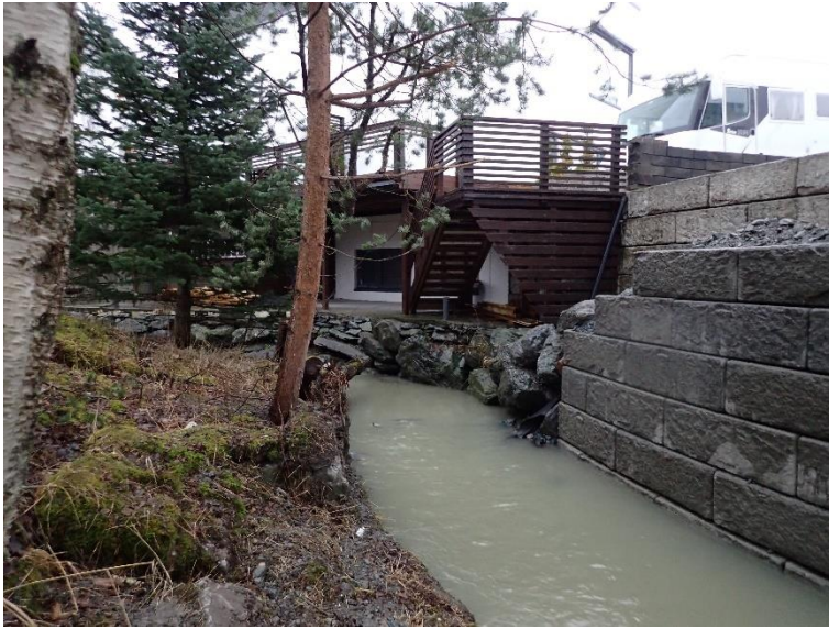
Figur 14 Presthusvegen 2B sett fra nedstrøms. Presthusvegen 2A har i desember 2021 fått satt opp en ny mur mot Sjøskogbekken.
