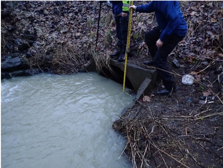
Figur 6 Inntaket til kulverten som går gjennom E6. Foran inntaket til kulverten med dimensjon \varnothing 1600 mm er det en rist med en høyde på ca. 110 cm. På dagen Rambøll var på befaring (17.12.21) var risten dekket med greiner, sedimenter og annet drivgods, noe som gjør at kulverten har redusert kapasitet.
