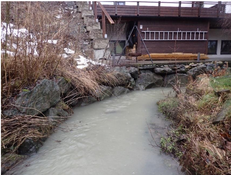
Figur 13 I svingen oppstrøms Sjøskogbekken ligger Presthusvegen 2B. Eiendommen har en terrasse som ligger lavt (målt til kote 3,7 m). På bildet ser vi også at det er vinduer som ligger lavt i kjelleretasjen.
