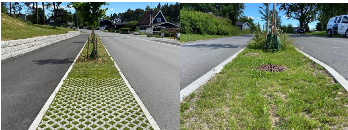
Figur 4: Eksempel på urban grøft hentet fra Norconsult sitt prosjekt i Hamar. Gressarmering i avkjørsel til privat bolig, 0-vis kantstein som lar vann renne ned fra både kjørefelt og gangareal. Sluk med jevne mellomrom.
