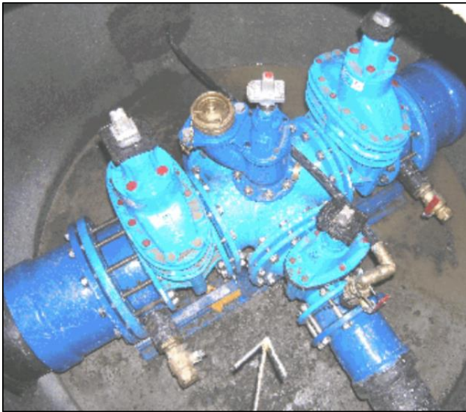
Figur 2 Vannkum 13276, bygd i 2006
