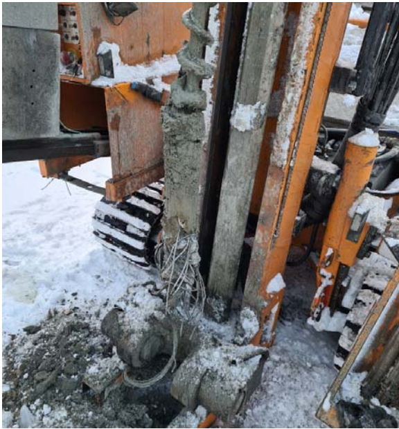
Figur 19: Stålwire påtruffet i SK7 fra 3-4 m under terreng. Foto: Multiconsult.
