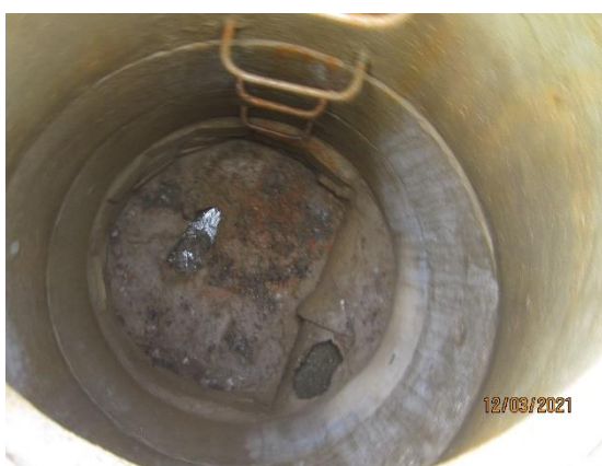
Figur 5: Kombinert spill- og overvannskum 31416
