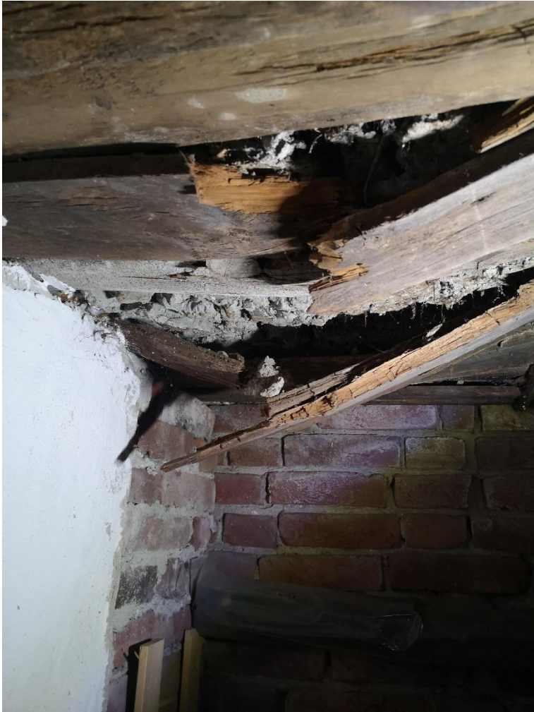
Figur 2: Etasjeskiller ved trapp. Her har bordene brukt som forskaling gitt etter. Tyder på at også betongplata har betydelige deformasjoner.
