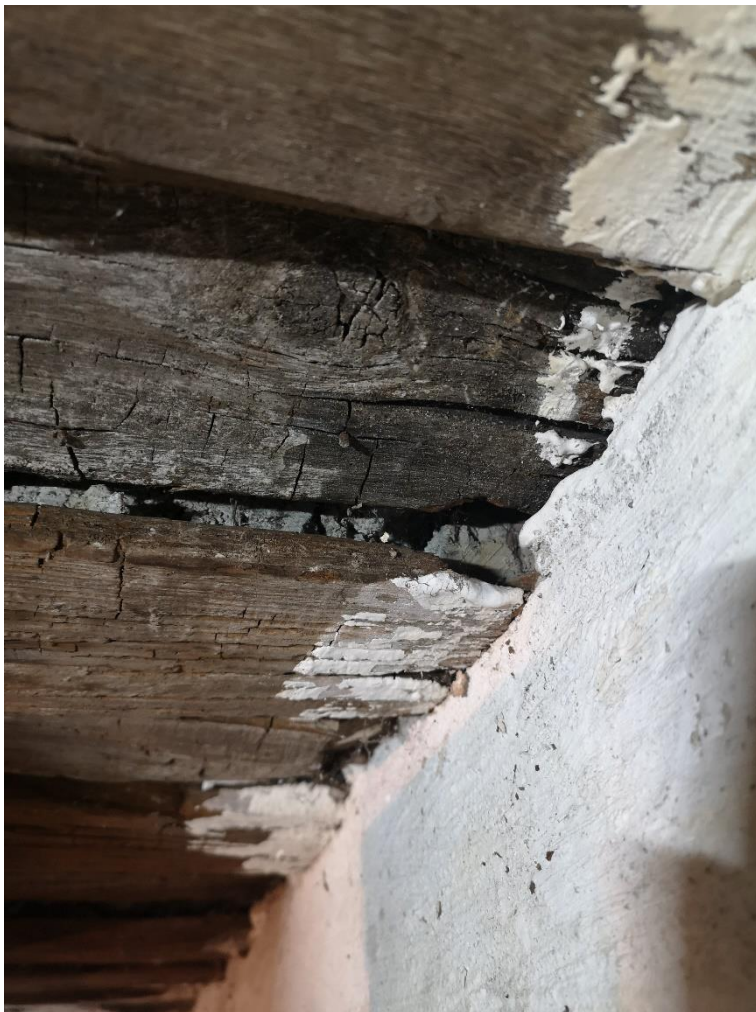
Figur 1: Etasjeskiller er i usikker stand og vanskelig å inspisere.
