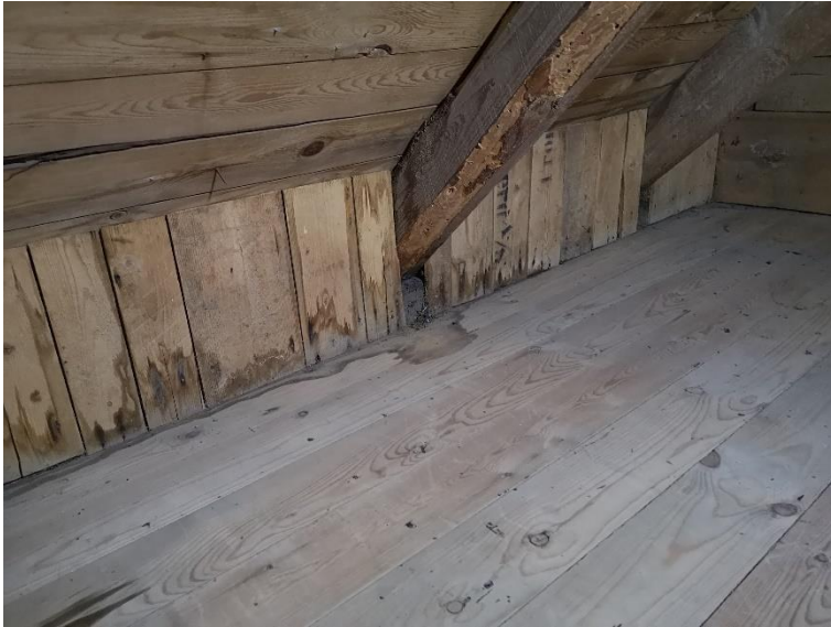
Figur 7: Takkonstruksjon med tegn på fuktinnsig.
