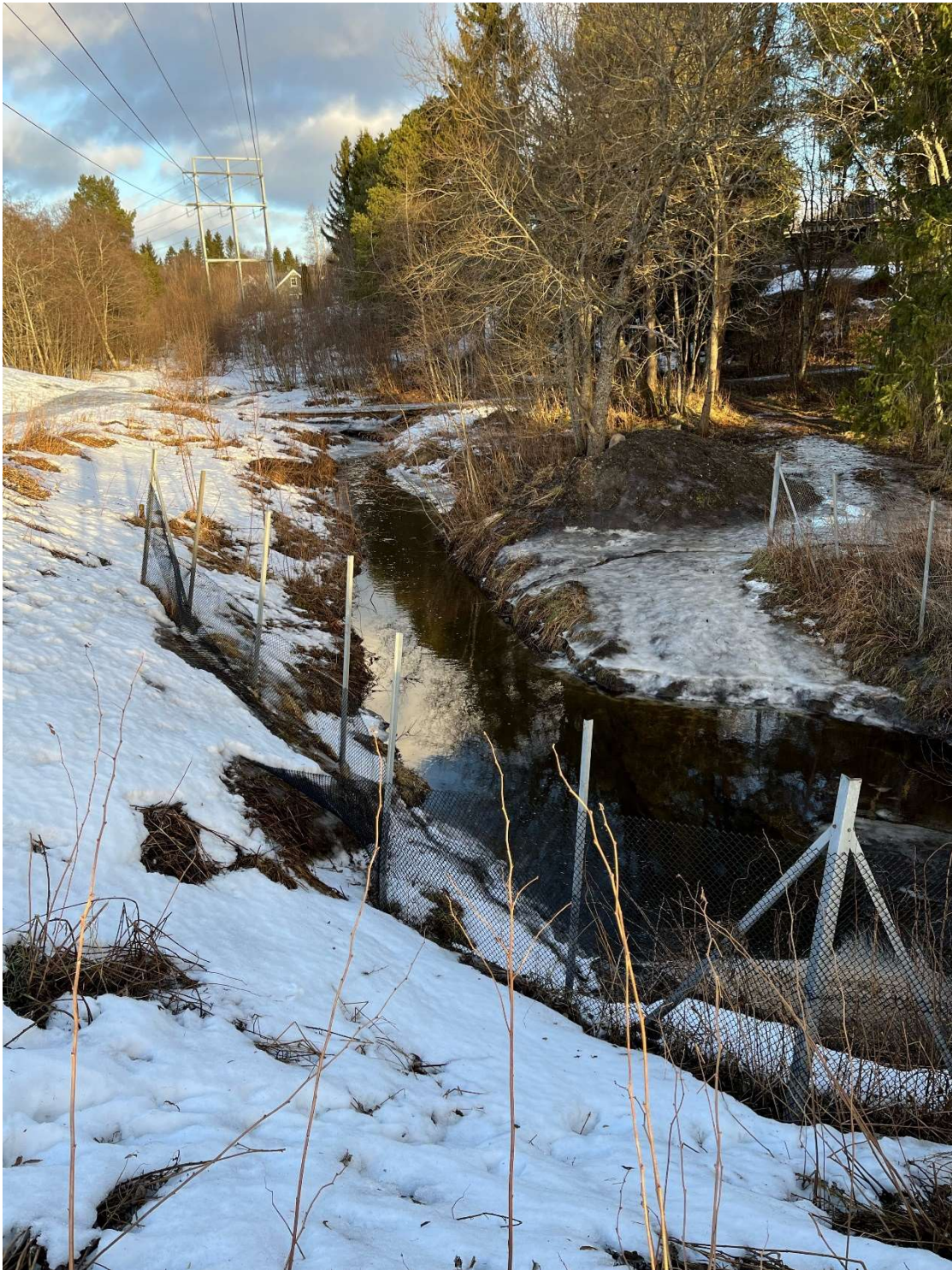
Figur 4-1: Bilde fra Eggen arkitekter sin befaring. Bildet viser vannstand ved inntaket til kulverten oppstrøms skoleområdet.
