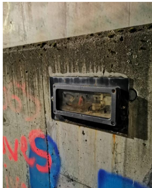
Dårlig belysningsnivå med nedtaggede armaturer
