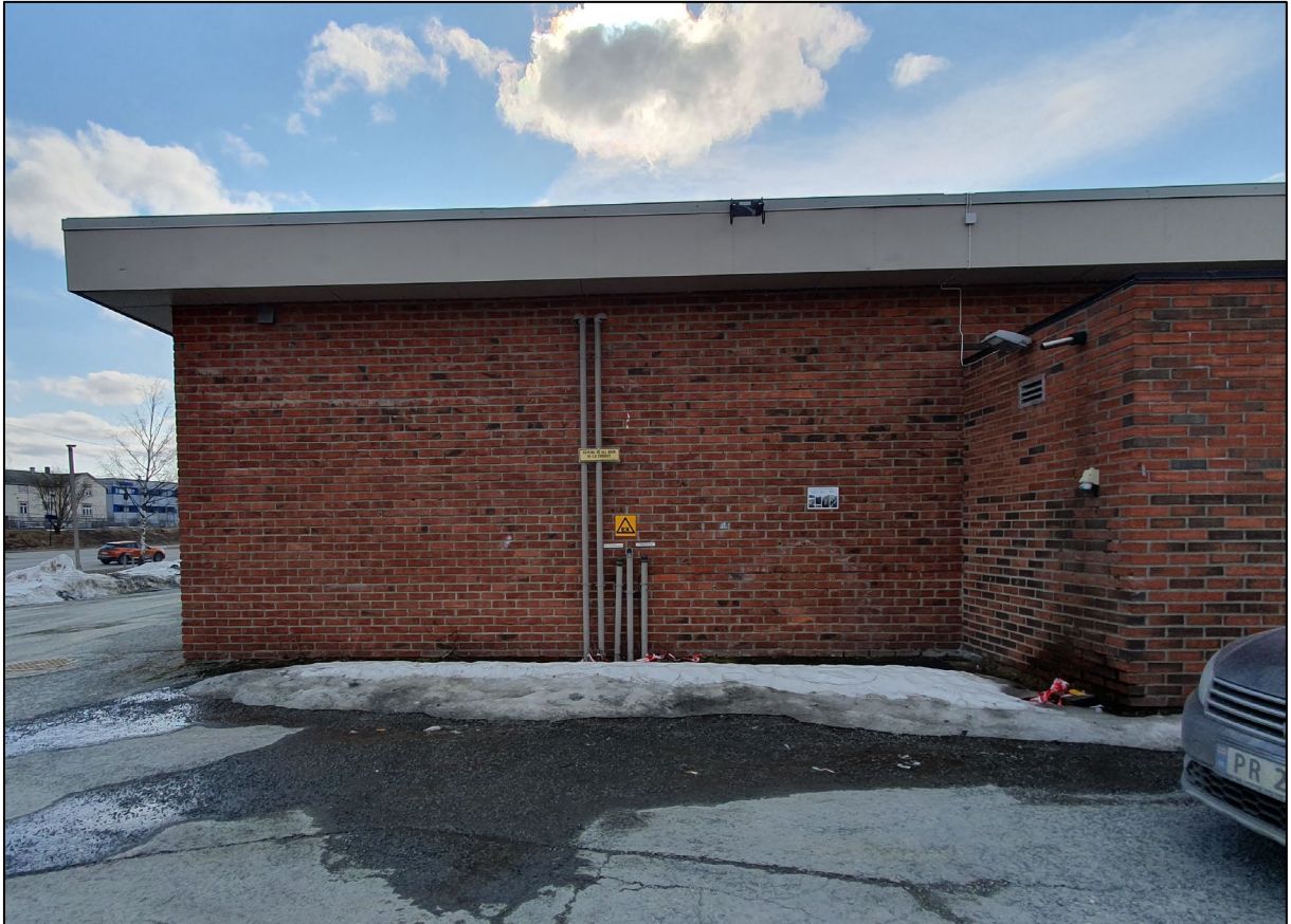
Figur 20: Nordsiden av bensinstasjonsbygget i Søbstadvegen 5. Det er antatt at dette er luftrør og påfyllingsrør for nedgravd fyringsoljetank og oljeutskiller. Foto: Multiconsult.
