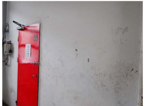
Figur 15 Hvitmalt puss på vegg i smørehall, prøve B7.
