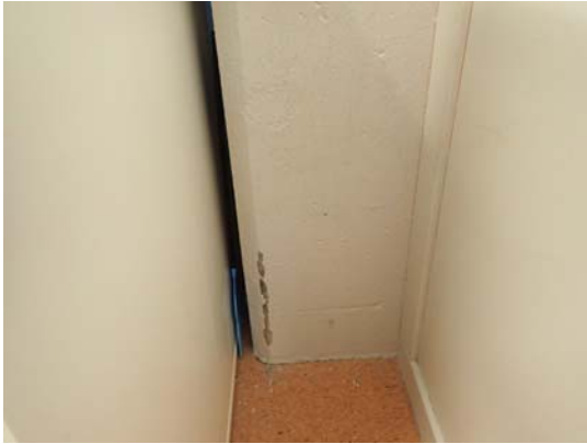
Figur 13 Hvitmaling på søyle i frisørsalong i 1. et. (tilbygg).
