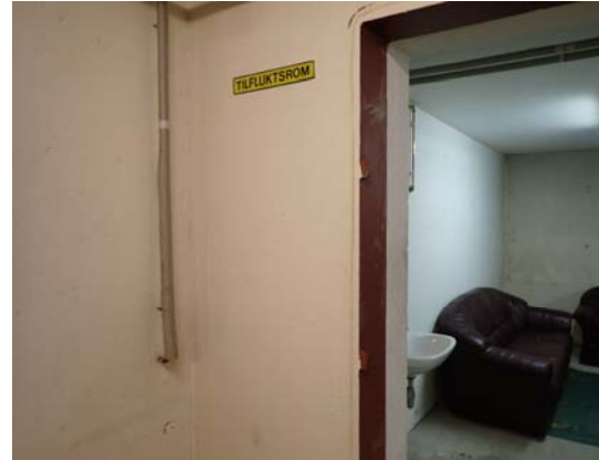
Figur 14 Hvitmaling på betongvegg i kjeller i tilbygg, prøve S3.
