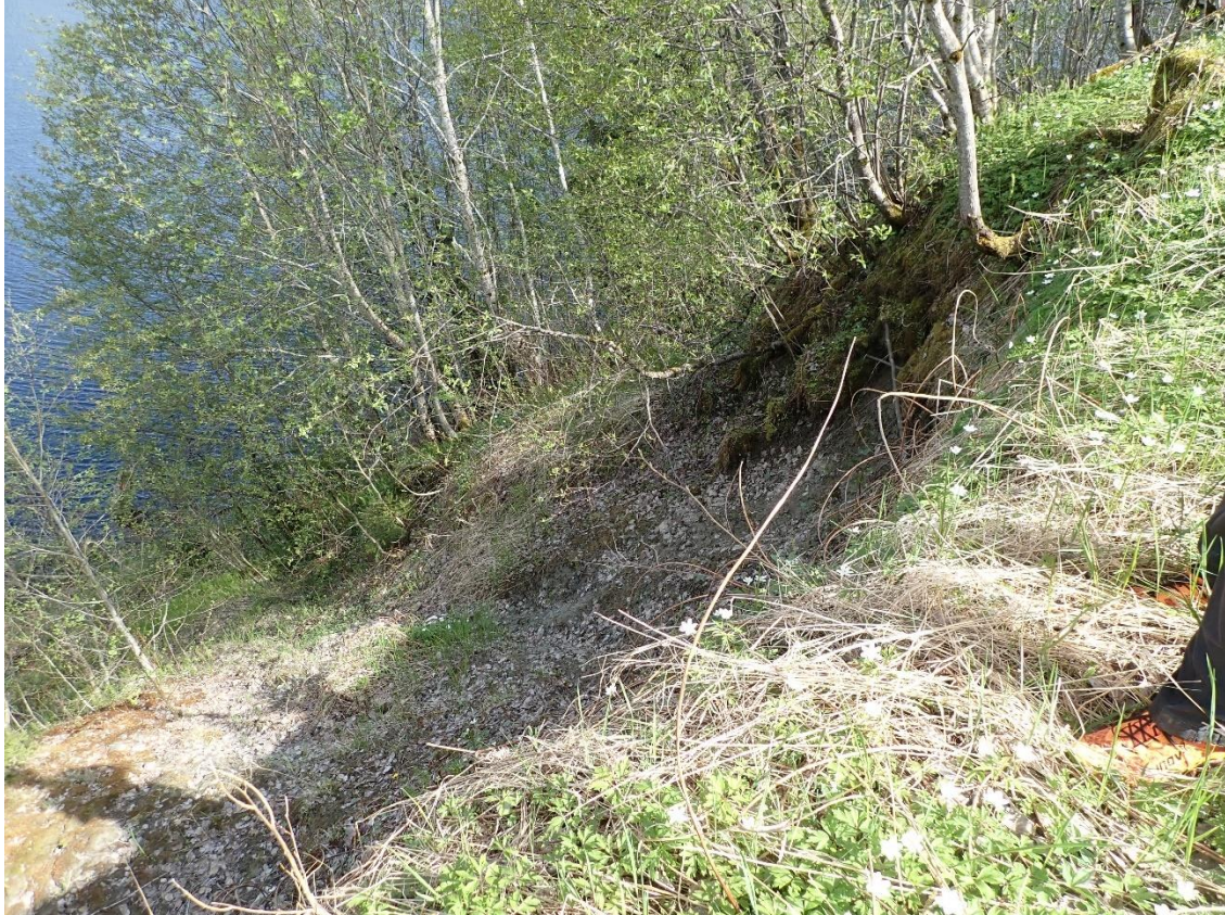
Figur 17: Én av utglidningene ned mot elva nord for Tanemsbrua.
