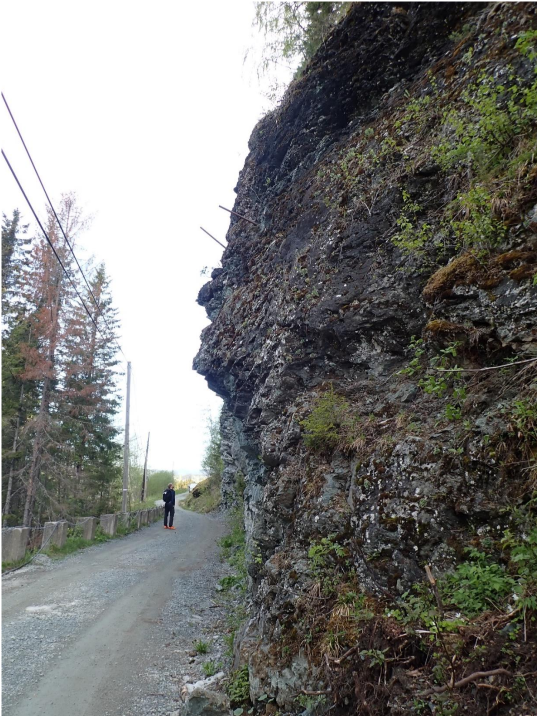
Figur 10: Skjæring ved lokalitet 2. Overhengende parti over vei/sti. Skjæringen fremstår svært knollete og oppsprukket.
