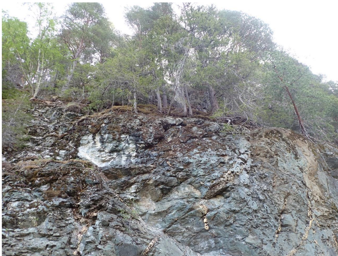
Figur 12: Sørlig del av skjæringen ved lokalitet 3 er noe oppsprukket og vegetert nær toppkanten. Terrenget bak skjæringen er også svært bratt.
