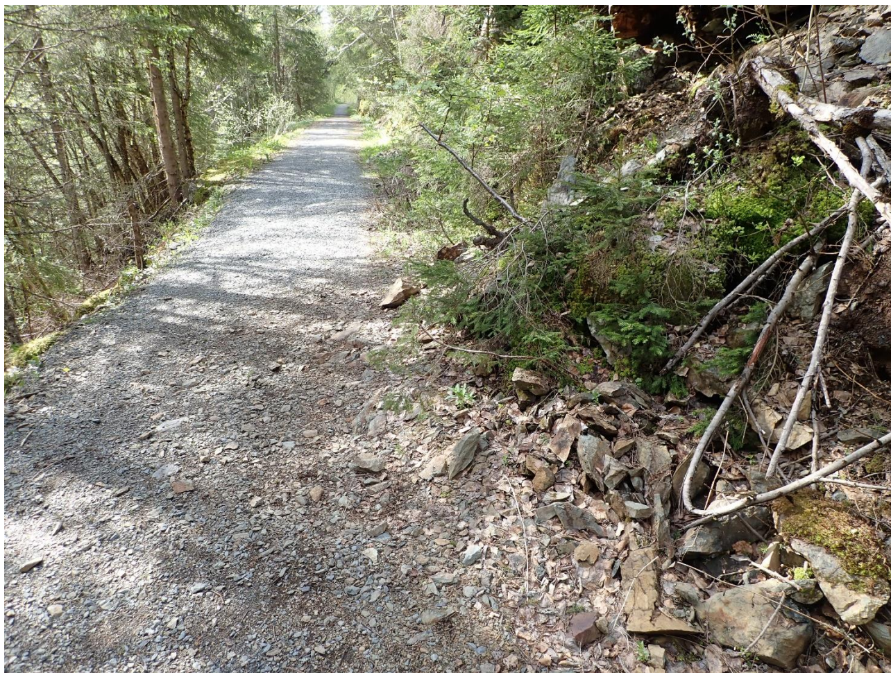
Figur 6: Overflateforvitret berg har rast ut og ligger delvis inne på stien.
