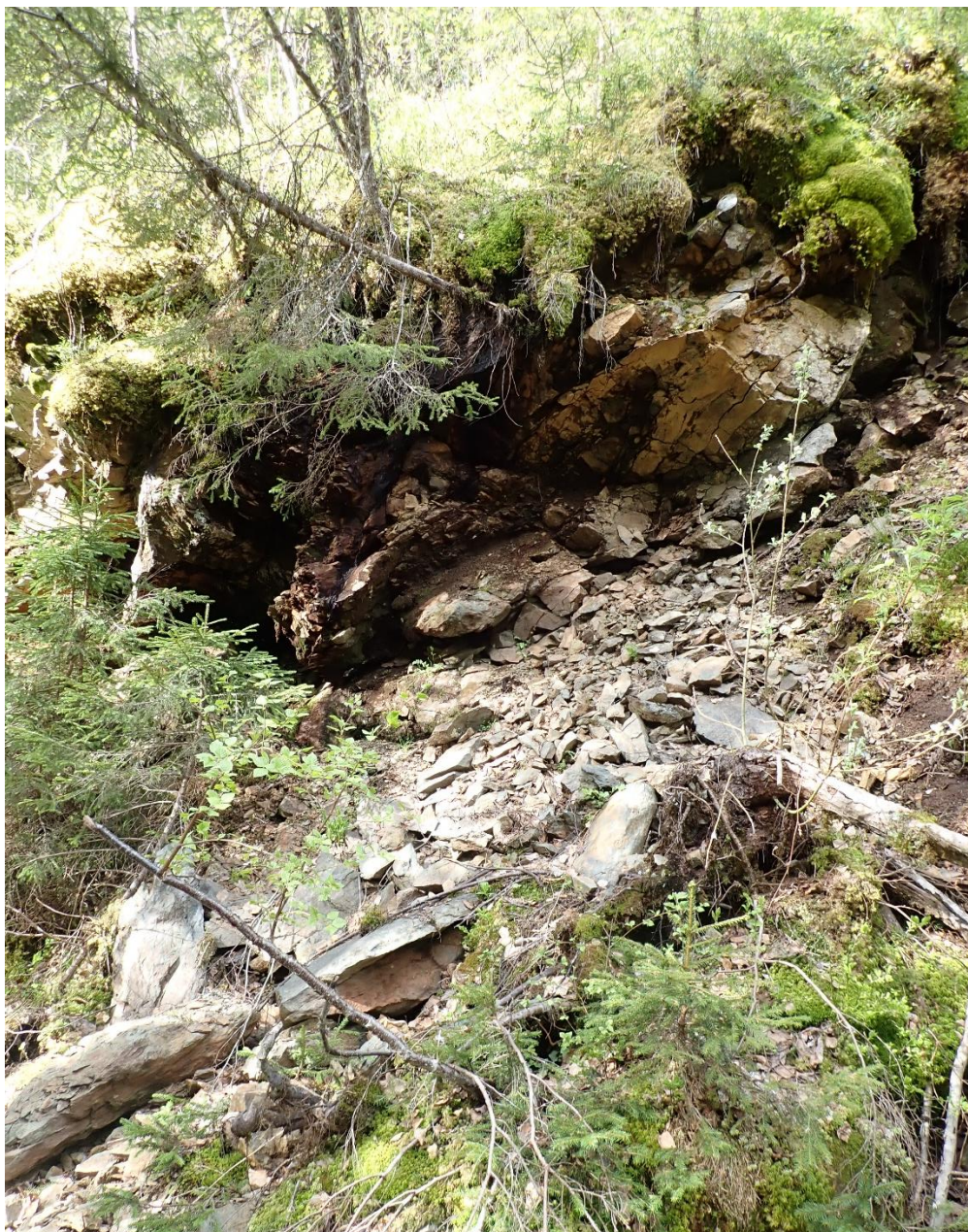
Figur 7: Toppkanten av skjæringen er dekket med mye vegetasjon. Bergmassen viser tegn til oppsprekking langs et skifrihetsplan som tilsynelatende utgjør avløste partier langs en glideflate.
