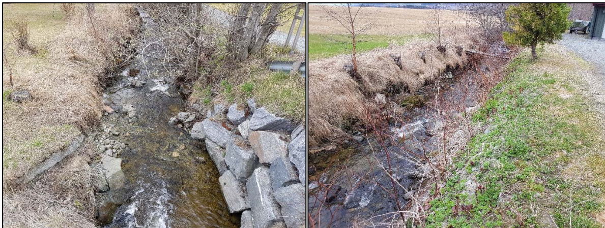
Bilde 10 og 11 - Utløp nedenfor planlagt G/S vei
