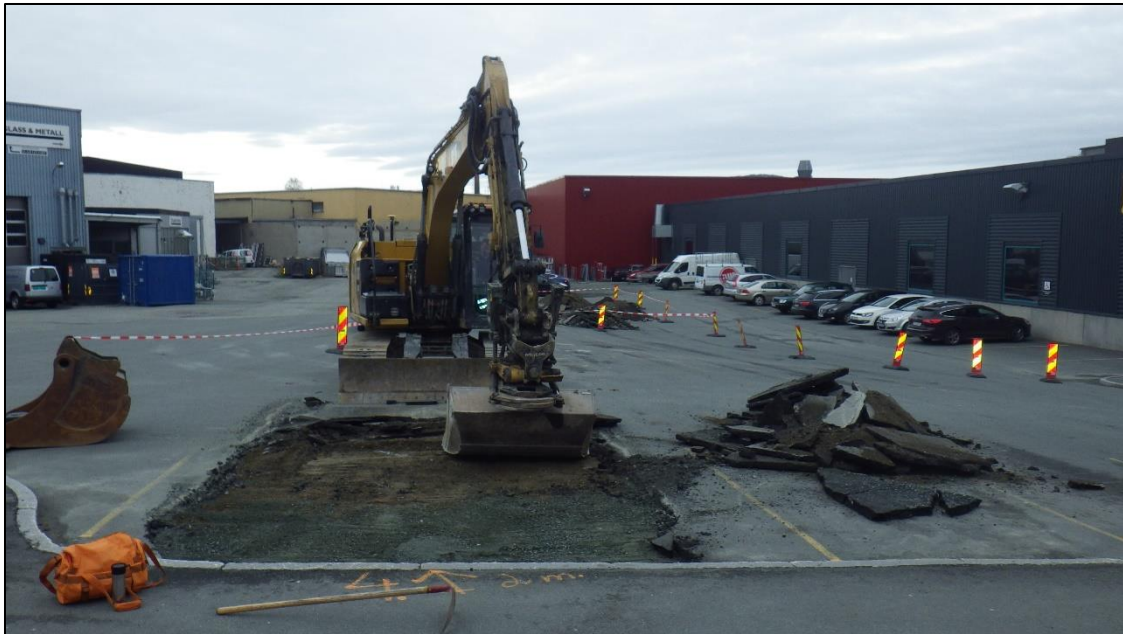
Figur 1: Jarlheimssletta bød på utfordringer, med asfaltert dekke og mye aktivitet. Her er Michael Trøan i gang med gravinga av sjakt 2.
