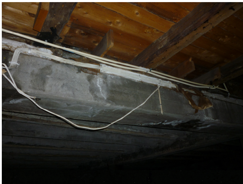
Underliggende drager, fuktskader.
