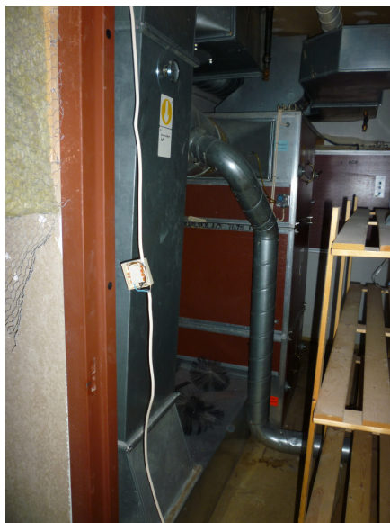
Teknisk rom med ventilasjons aggregat i 2. etasje
