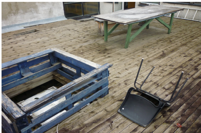
Takterrasse i dårlig forfatning, lekkasje mot glassgård.
