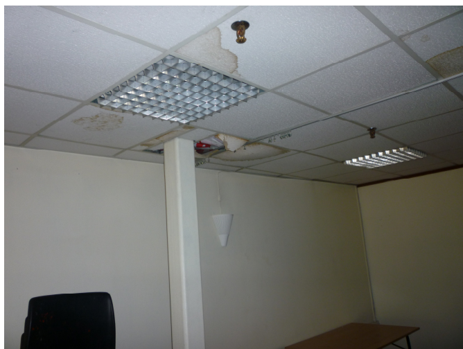
Vannlekkasje fra overliggende takterrasse.
