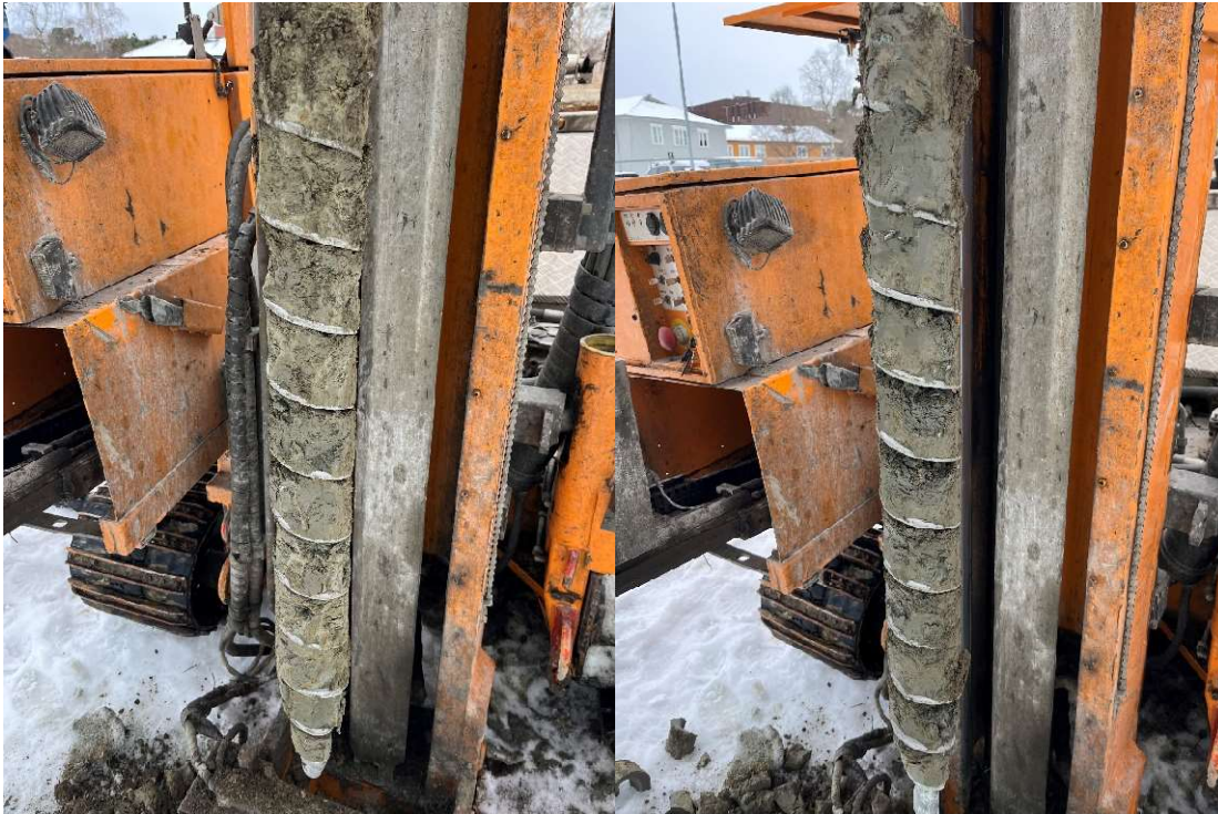
Figur 4-3 SK5 1-2 meter og 2-3 meter. Antatt tørrskorpeleire over hard leire. Antatt å været original grunn.
