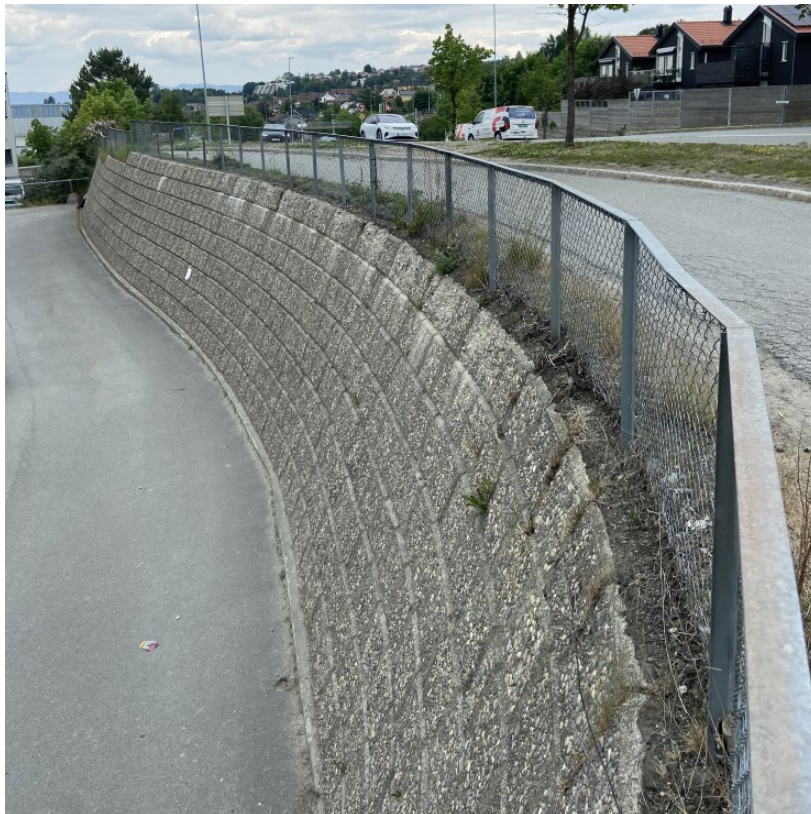
Figur 5-8: Eksisterende mur ved Nardovegen 16B. Muren er satt som et fastpunkt og kan dermed ikke belastes ytterligere. Foto: Multiconsult
