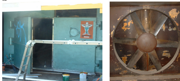
Materialtørka har kraftige ståldører inn til tørkekammeret hvor de store viftene gir luftsirkulasjon.
