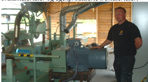
Arbeidsleder Svein Erik Graadal i arbeid med å montere elmotor for drift av saga.
