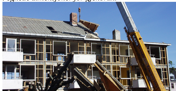
Etter fjerning av takstein for gjenbruk, ble takflatene løst i store seksjoner.
