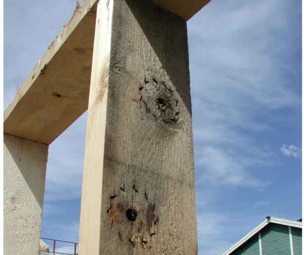
Slike skader har liten styrkemessig betydning for materialer i stenderverket.
