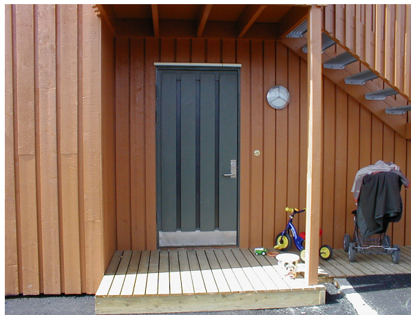
De ombrukte ytterdørene måtte skiftes etter første bruksår fordi kvaliteten var for dårlig.
