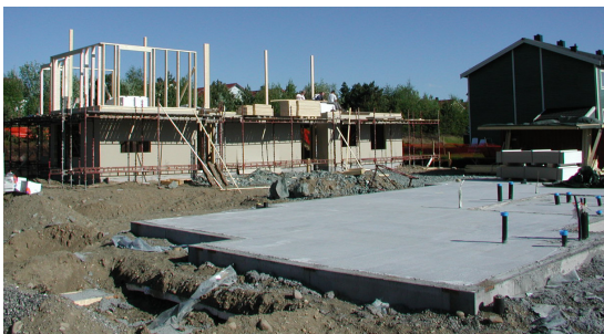
Grunnmuren til Gjenbrukshuset ble støpt uten det planlagte tilslaget av returbetong. Nybygget under oppføring sees i bakgrunnen.
