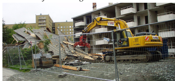
Etter at takseksjonene var stablet på bakken ble taktroen revet av med en hydraulisk grabb.
