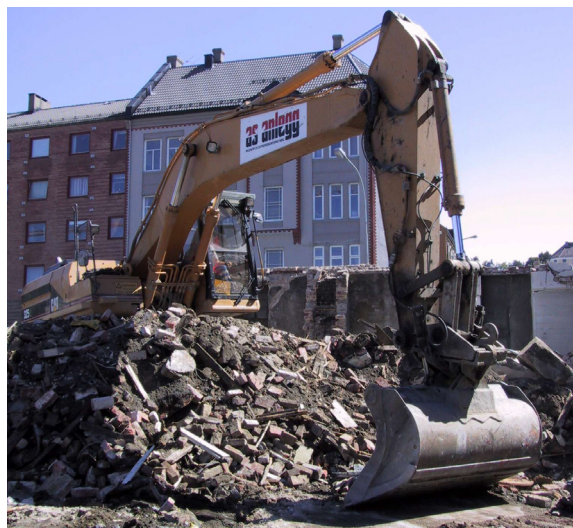
All teglsteinen til gjenbruk ble revet med maskin. Dette gjorde at ytterstein og mindre brent innerstein ble blandet. Ideelt sett bør teglsteinen sorteres av kyndige på riveplassen.
