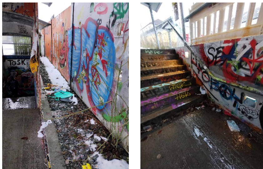
Bilder tatt fra kjent undergang på Lademoen Morten Fagervik's og tilhørende sti.
