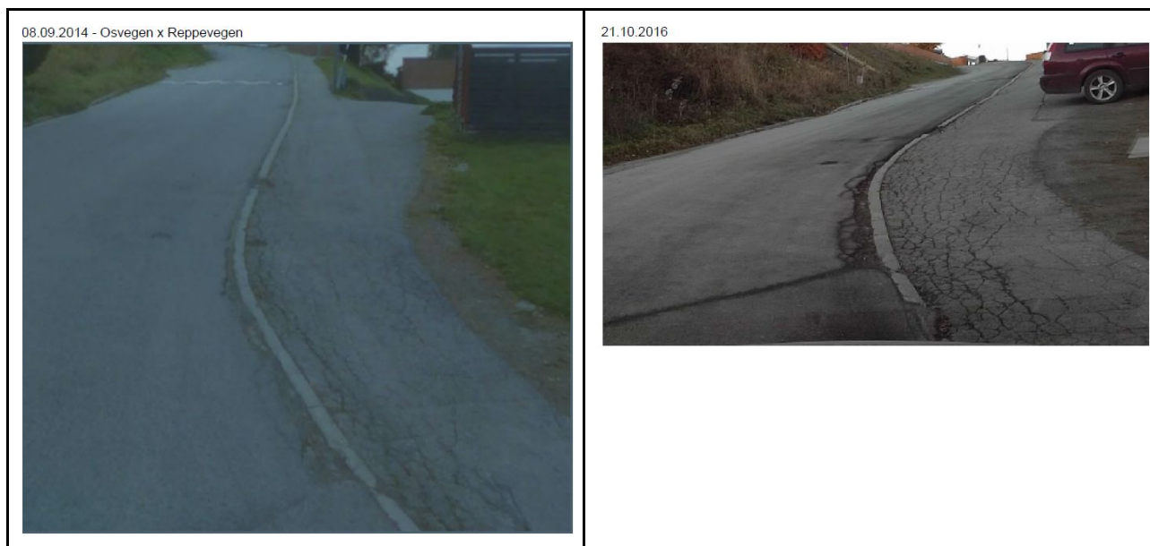
Figur 10: Bildene viser del av Reppevegen og endring i kvalitet på asfaltdekket i løpet av to år (2014 - 2016) uten vedlikehold.
