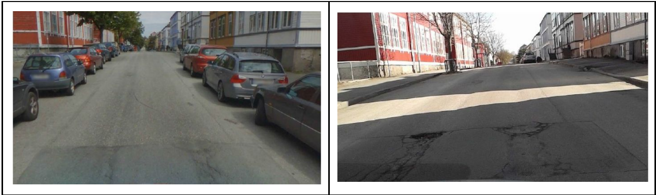
Figur 11: Bildene viser et område i Weidemanns veg der det har vært gravearbeider og lapping av asfaltdekket. Etter to år (2014 - 2016) er området som er lappet, kraftig krakelert.
