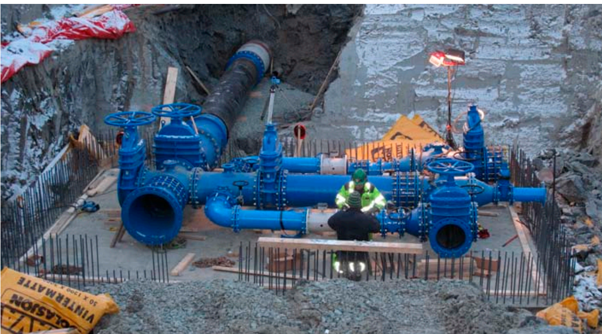
Fordelingskum for vannforsyning, Gildheim, E-6 øst. (Foto: G. Grøtan)
